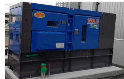
<非常用電源設備>
